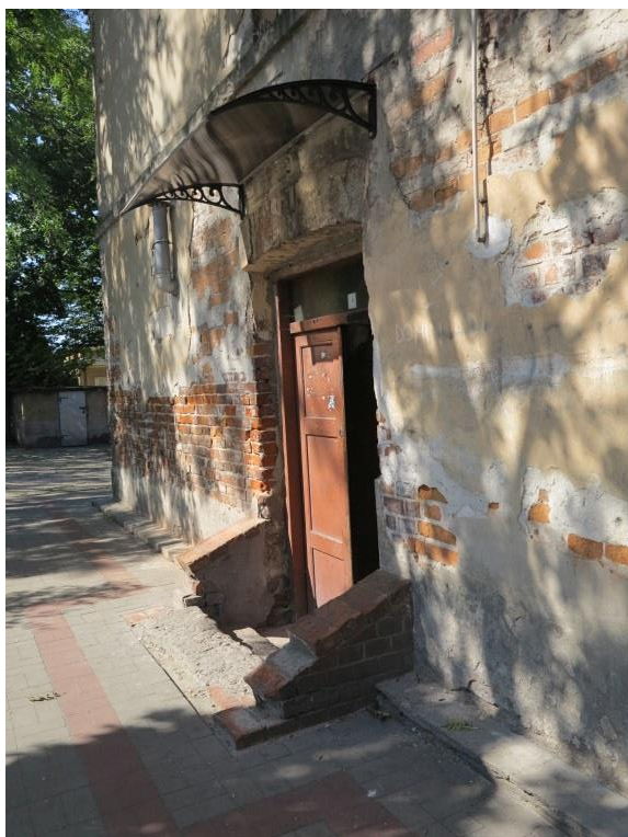
Fragm. elewacji budynku mieszkalnego;
